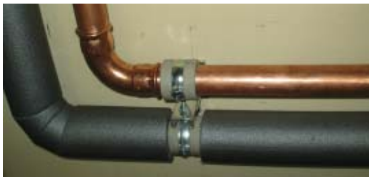
Rys. 3.15.2. Przykład łuku w technice zaprasowywanej Ø54 bez osłony i z prawidłowo założoną z klejonych segmentów izolacją typu Termaflex
